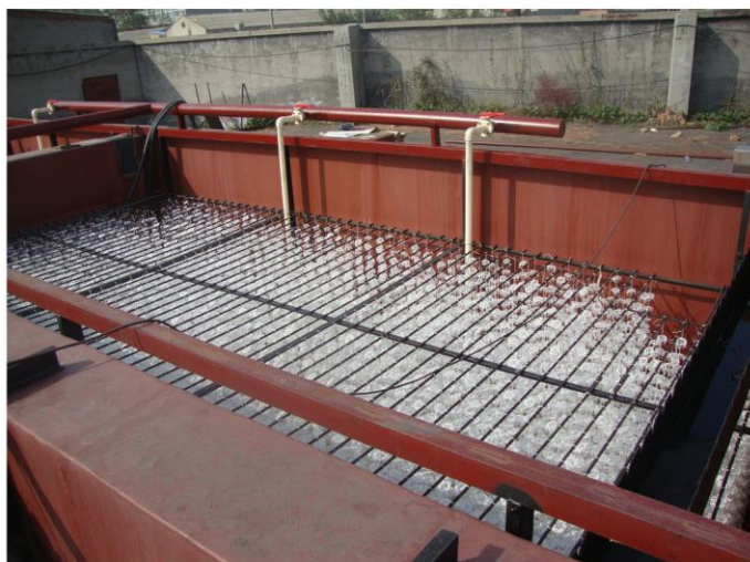
Waste water recycle 污水循环处理
